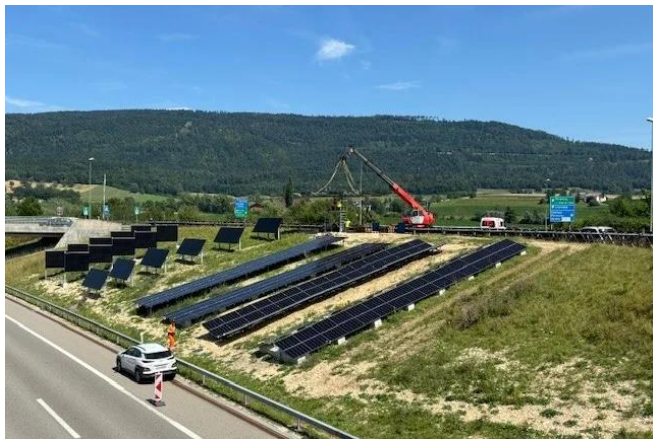
Installation test avec différentes configurations pour entretien et biodiversité
