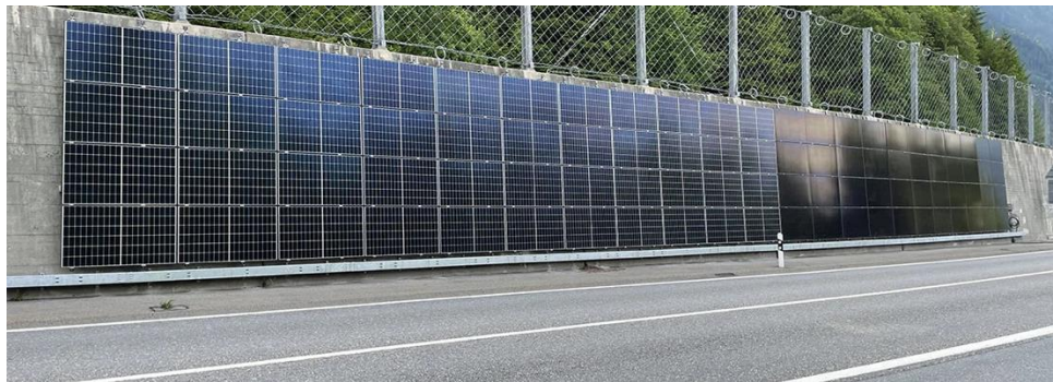
Installation test avec panneaux amovibles pour inspections
